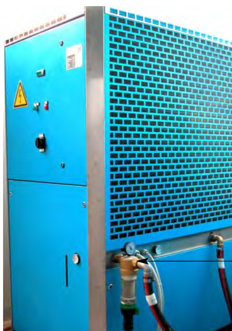
Abb. A Anordnung des Filters auf dem Kühlaggregat
